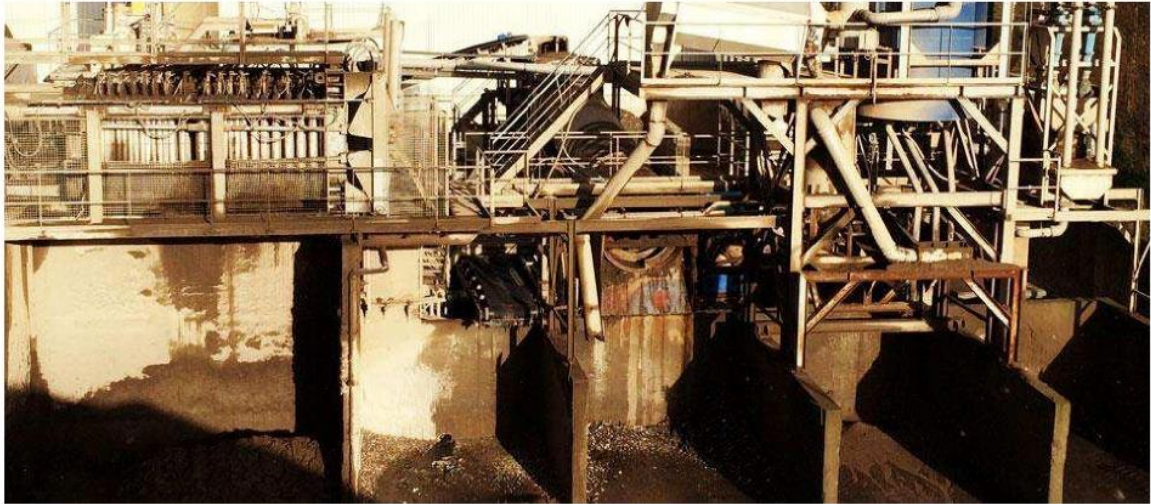
Figure 2 : vue des installations Petillion en Belgique (extrait Internet)
